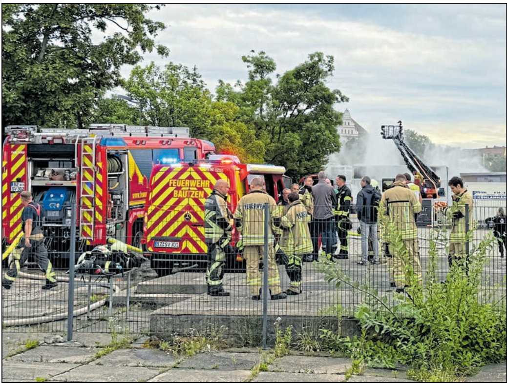
In der Nähe des Schlieben-Parkplatzes brannten vier Seecontainer einer Batteriespeicheranlage – auch noch zum Zeitpunkt des Redaktionsschlusses dieser Ausgabe. Foto: Stadtverwaltung Bautzen
