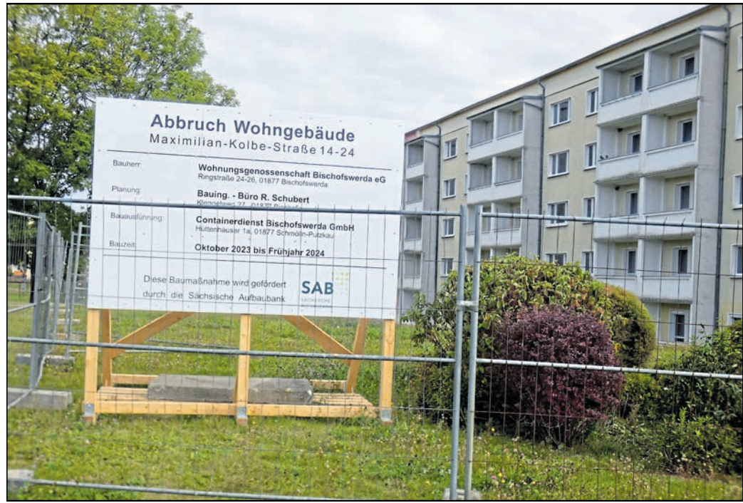
Auch das ist Bischofswerda-Süd: An der Maximilian-Kolbe-Straße beginnt bald der Abriss einer ganzen Häuserzeile.
